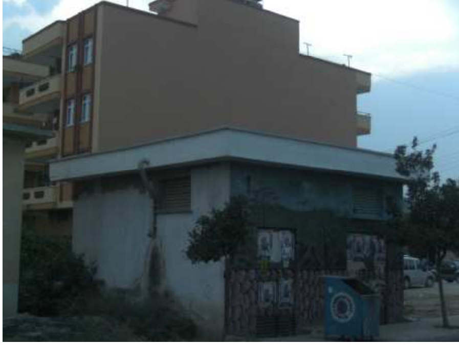
Yüksek gerilim, elektrik trafosu (yer trafosu) (PTT Evleri Mah.)
