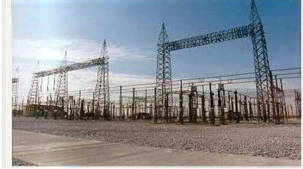
Yüksek gerilim hattına sahip şalt sahası.
