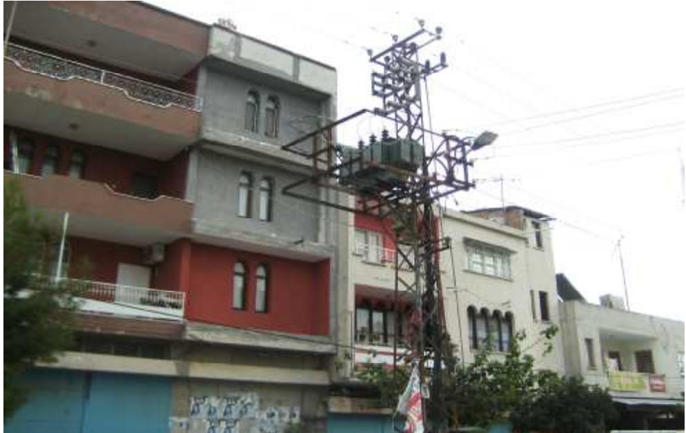
Yüksek gerilim, havayı hattı elektrik trafosu (PTT Evleri Mah.)
