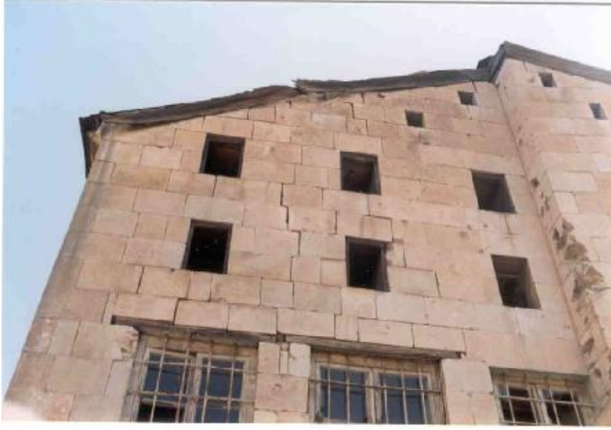
Şekil 4.92. Duvardaki çatlak ve taşlardaki aşınma
